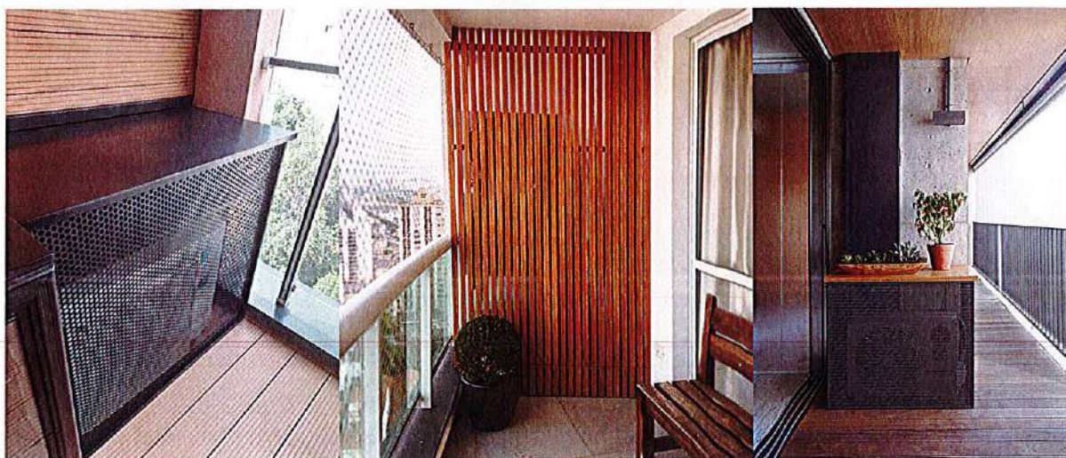
Exemplu de mascare a aparatelor de aer condiționat amplasate pe balcon. a. Tablă perforată b. Riflaj lemn
